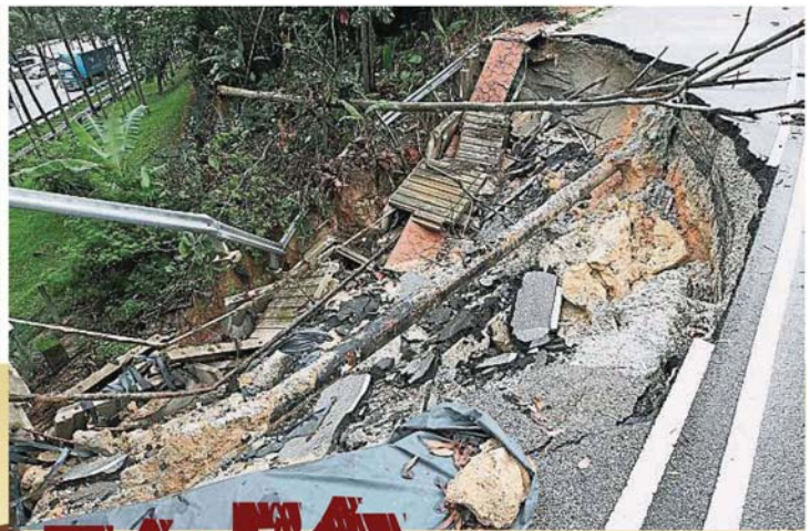
The Airie住宅区出入口前方的柏西兰美兰蒂路段出现土蚀地陷问题逾1个月，目前未有修复行动
