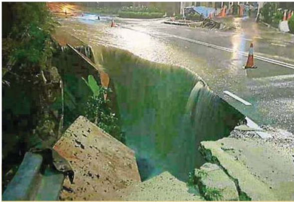
大量雨水从高处涌下土蚀地陷的路段，犹如瀑布般倾泻，让居民担心不已。（图片由温先生提供）
